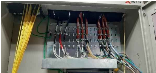
Mumbai (Kalyan) Fibre Cables
